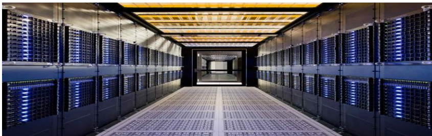
Shk Nr 14 një server room, me kapacitete të mëdha
